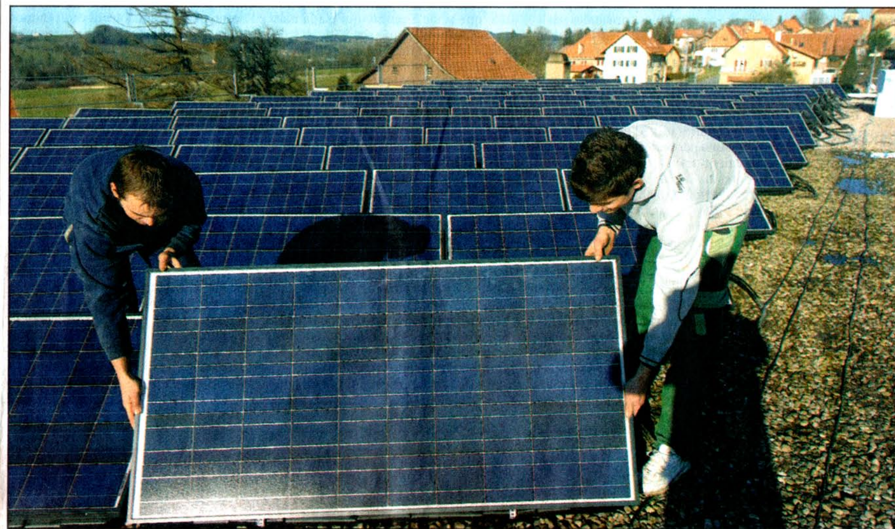
Avec ses 150 m 2 de panneaux, la menuiserie produira de quoi alimenter en électricité six ménages par an. VINCENT MURITH
