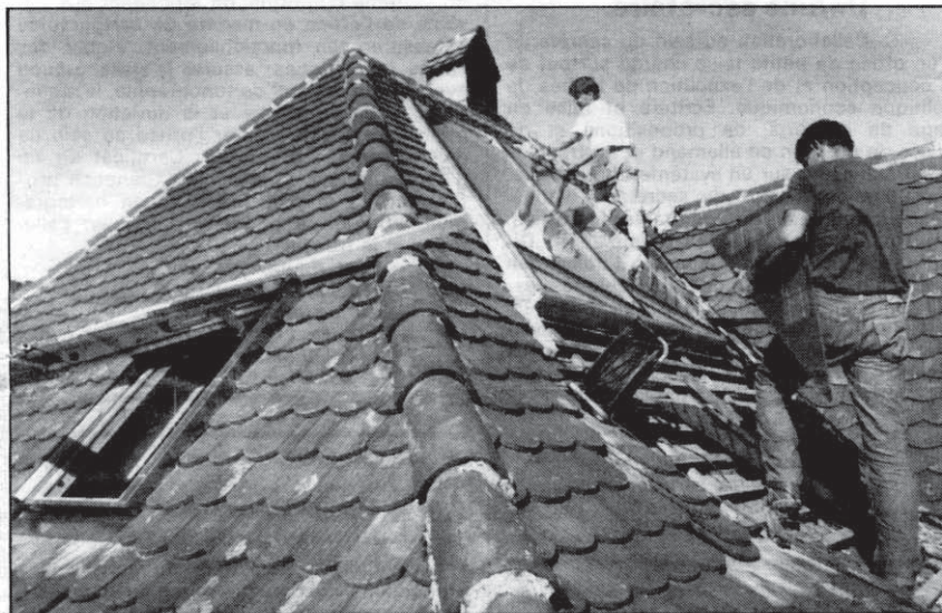
Un toit delémontain • Où l'on a installé hier un nouveau système de capteurs solaires à eau. (rm)
